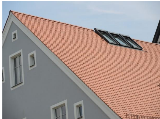
Untergeordnete Anlage aus Dachflächenfenstern
